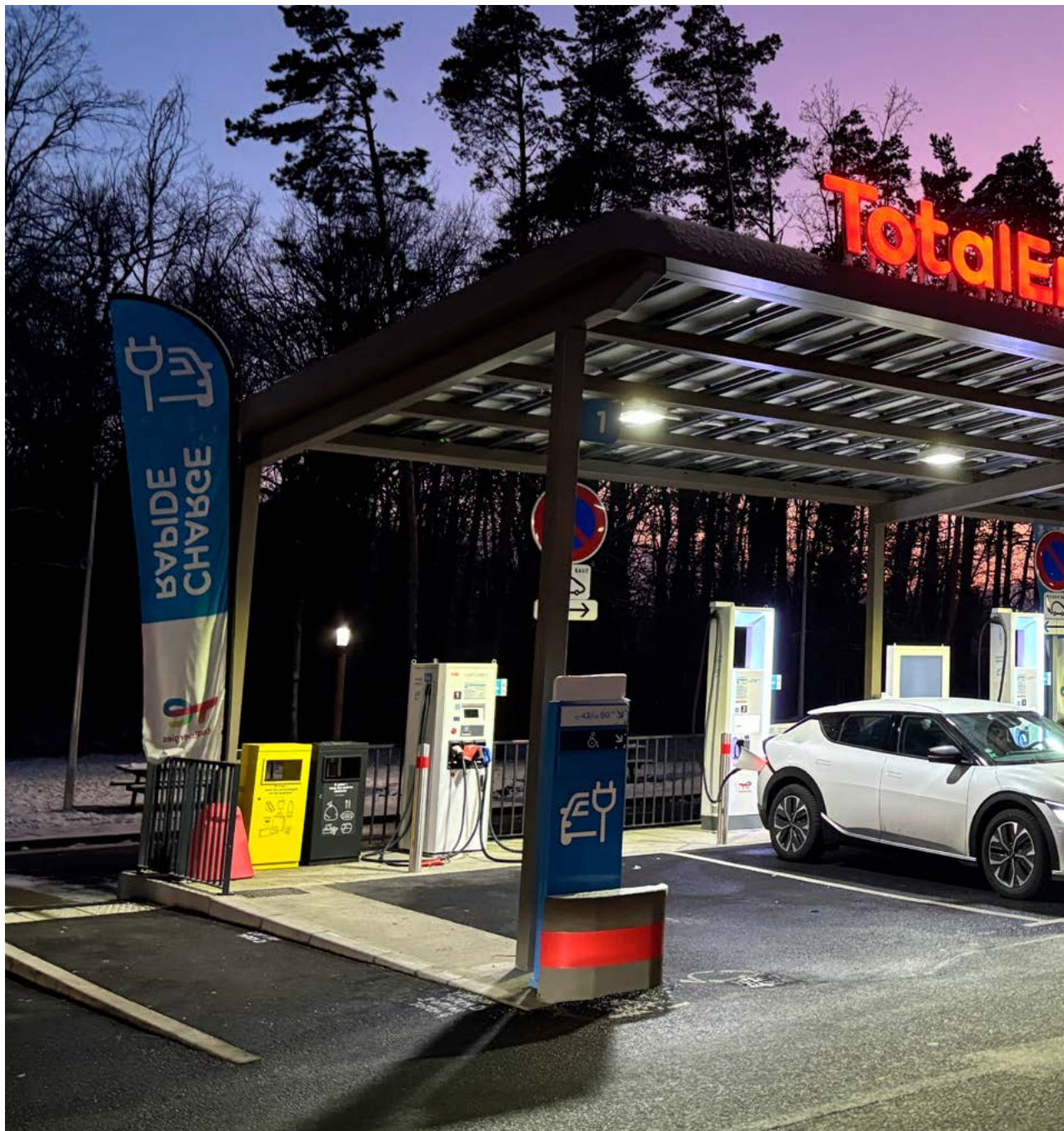
Station de recharge électrique sur l'aire de Limagne Sud (Puy-de-Dôme), sur l'A89.
